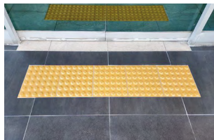
출입구 바닥 점자블록
