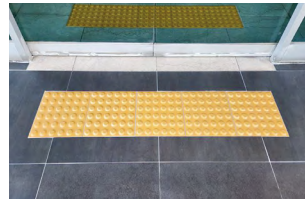
출입구 바닥 점자블록
